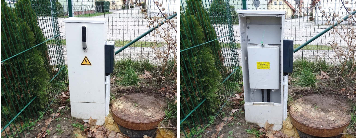
Abbildung 8 + 9: Hausanschlusssäule (verschlossen/geöffnet) im Versorgungsgebiet der VBH
