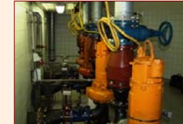
Pumpwerk - trocken aufgestellte Pumpen
